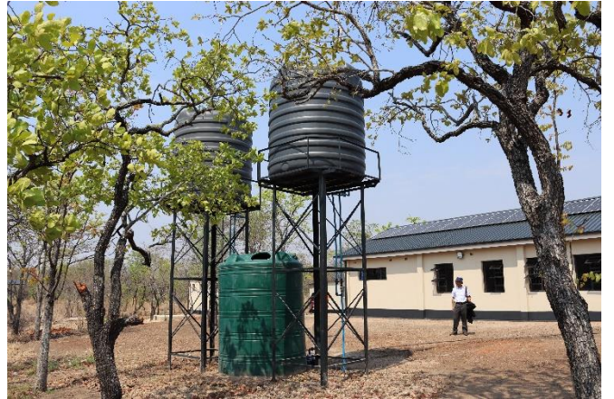
設置された水タンク
